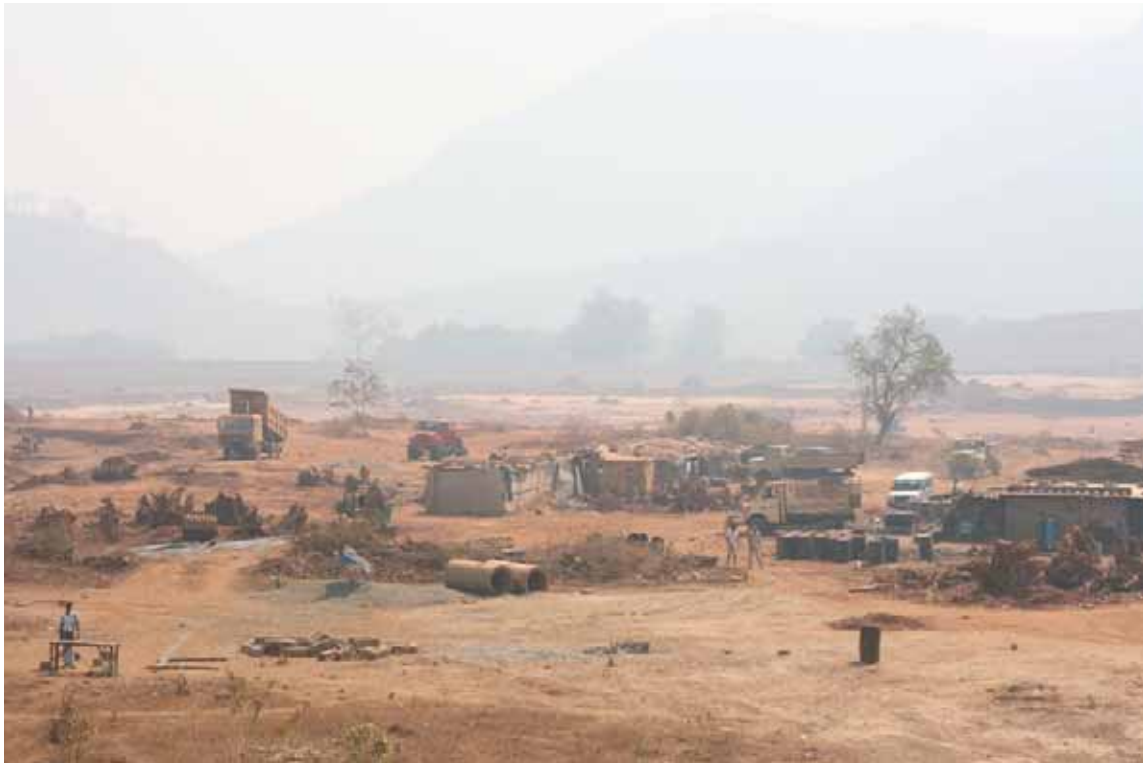
Photo 12 : Vue du dépôt de boues rouges en construction à Lanjigarh (Amnesty International)
