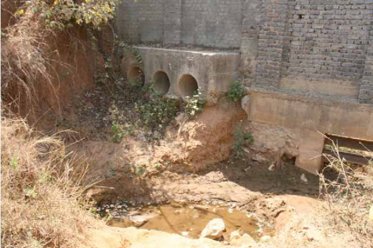
Photo 14 : tuyau d'évacuation sur l'enceinte de la raffinerie, près du fleuve, à Chhattarpur (Amnesty International)
